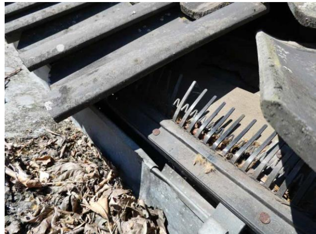
Figuur 12 Vogelschroten onder de dakpannen
