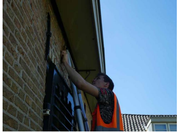
Figuur 14 Ruimte aan de noordwestkant van het huis tussen de goot en de muur te nauw voor vleermuizen
