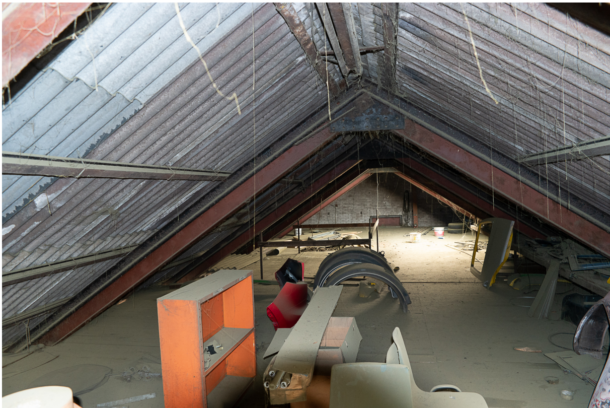
Zolder van de loods Burgemeester Bruntstraat 1, onder de dakplaten zijn geen verblijfplaatsen mogelijk voor vleermuizen en vogels door ontbreken van een dakbeschoot.
