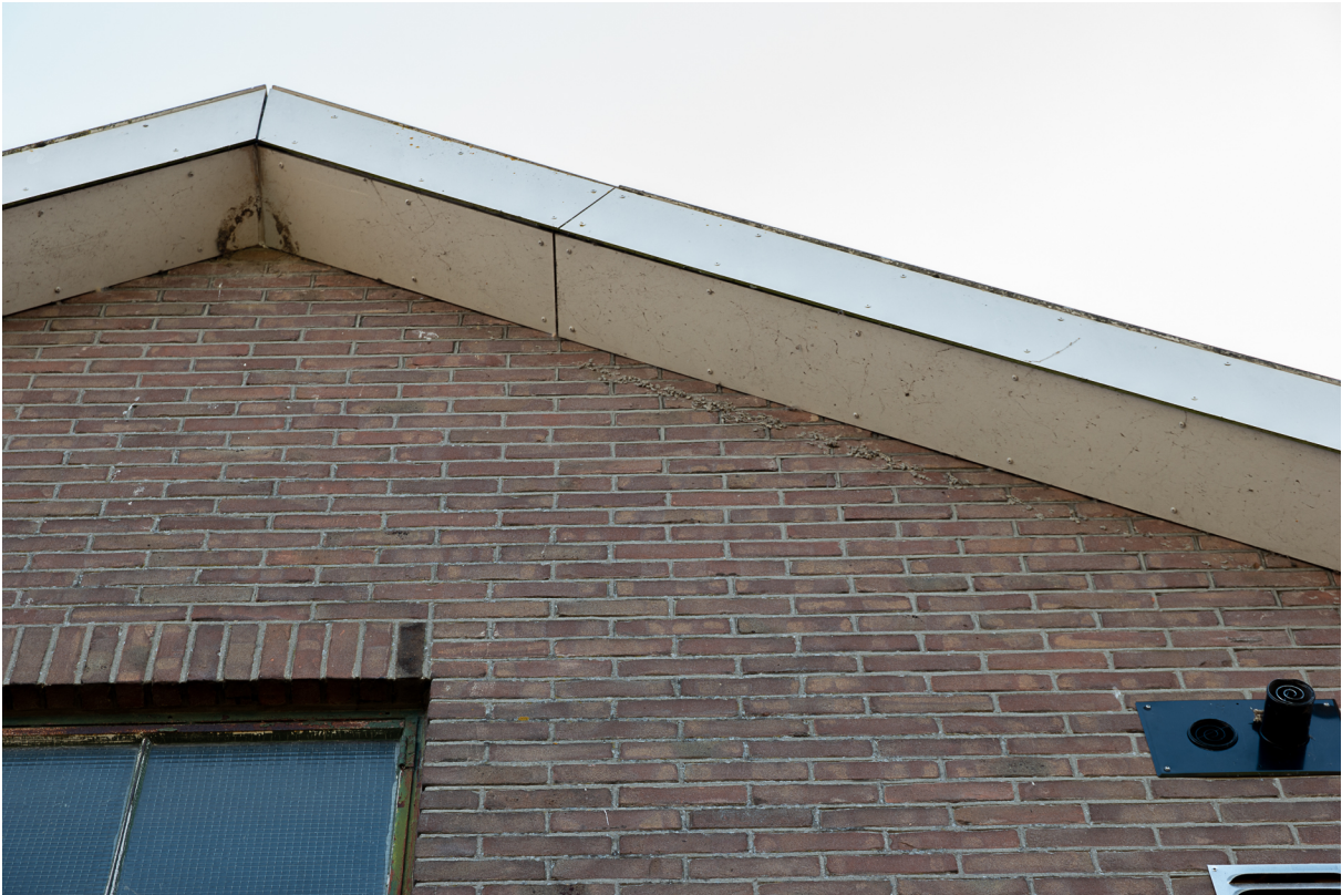
Oostgevel loods met op de boeiborden en muur sporen van huiszwaluwnesten, situatie 30 mei 2021.
