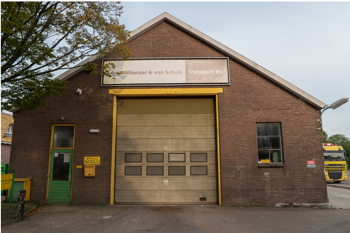
Westgevel loods Burgemeester Bruntstraat 1, rechts achter afwerking dakrand zit een spreuwenest.
