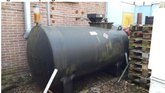
Figuur 20: Bovengrondse dieseloiletank (3.000 l.) achterzijde locatie Autoschade Hogenboom
