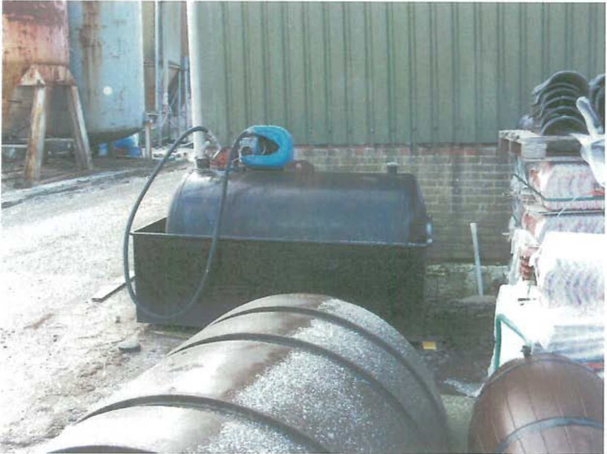
Foto 5: Zicht op bovengrondse dieseltank
