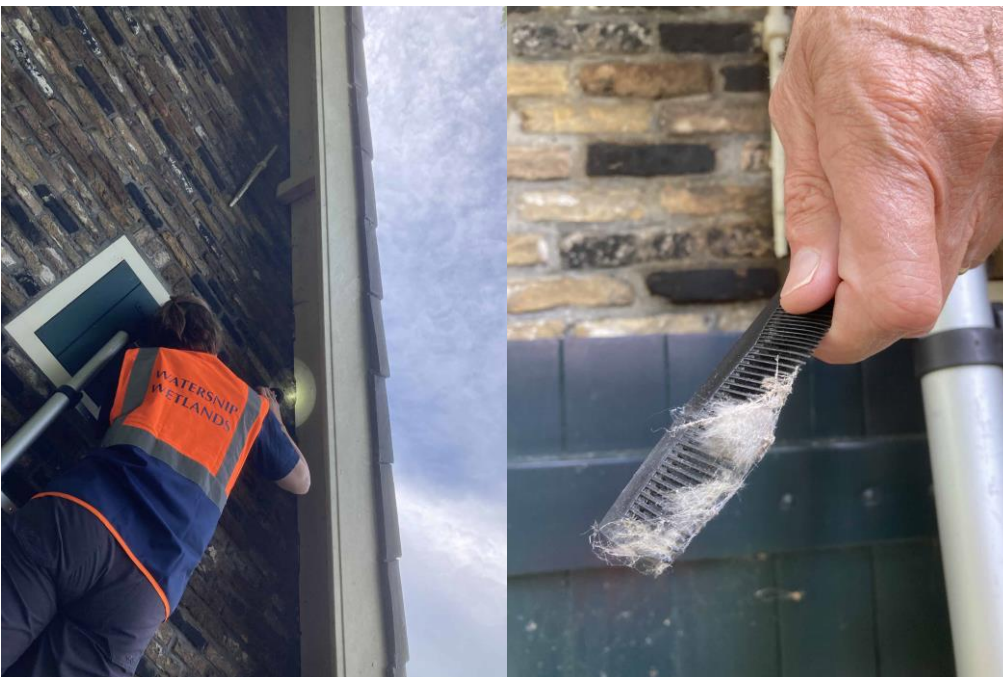
Figuur 18 en 19: Inspectie dakranden en aanwezigheid steenwol bij dakoverstekken
