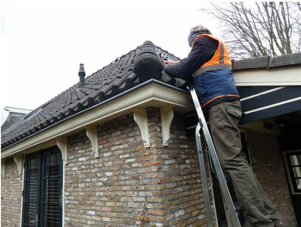
Figuur 6 Metingen naar ruimte tussen de dakpannen en gevel op zuidwestelijke hoek van het huis
