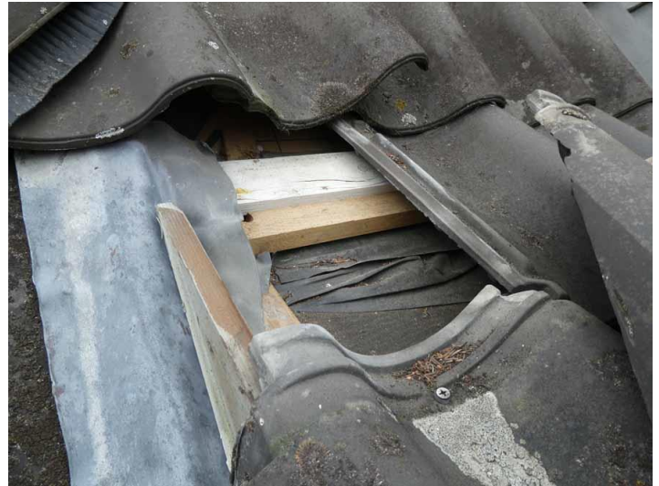
Figuur 14: Ruimte onder dakpannen, ontoegankelijk en ongeschikt voor vleermuizen. Hier een pan weggehaald voor onderzoek
