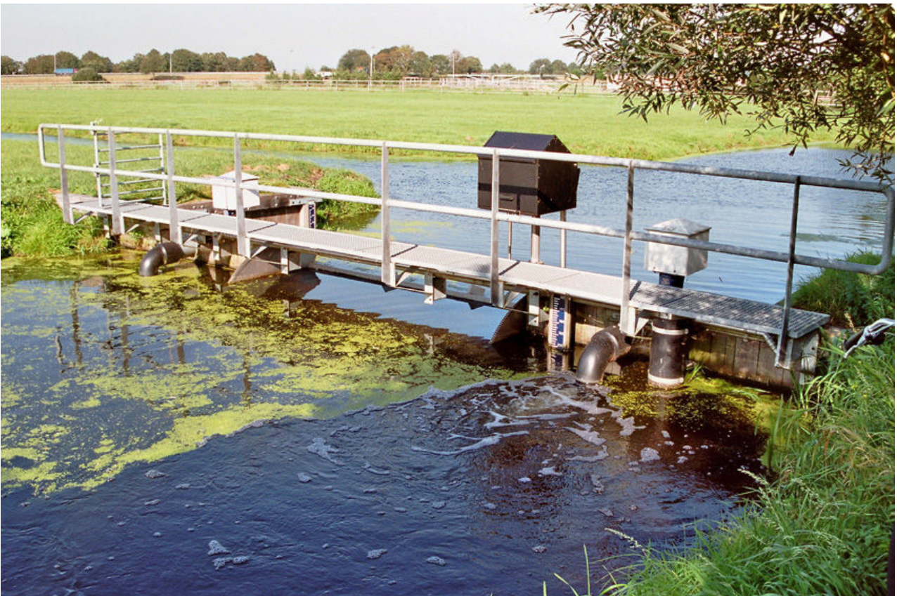
Figuur 58: Ontwatering langs het Oosteinde
