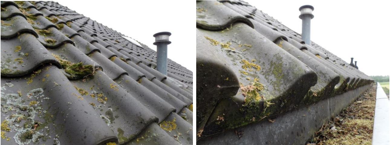
Figuur 9: Het pannendak van het woonhuis.
