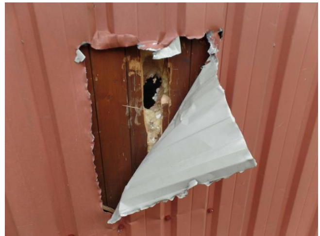
Figuur 5: Gat in de muur van het gebouw, waardoor verschillende lagen te zien zijn
