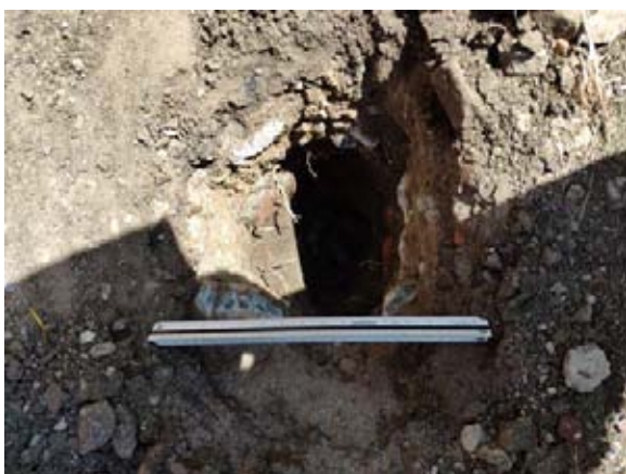
Deelplan A, inspectiegat IG21
