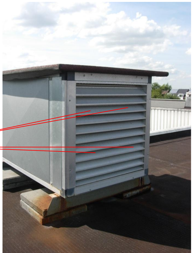
Figuur 5.3 Afbeelding van de meetlocatie aan de gereinigde zijde na het actiefkoolfilter van de kookketel.
