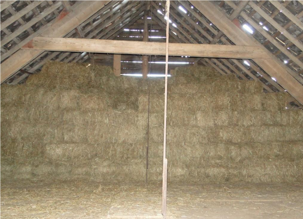
Figuur 12: Zolder van de grote paardenstal, kieren en gaten in de dakbedekking en achtergevel.
