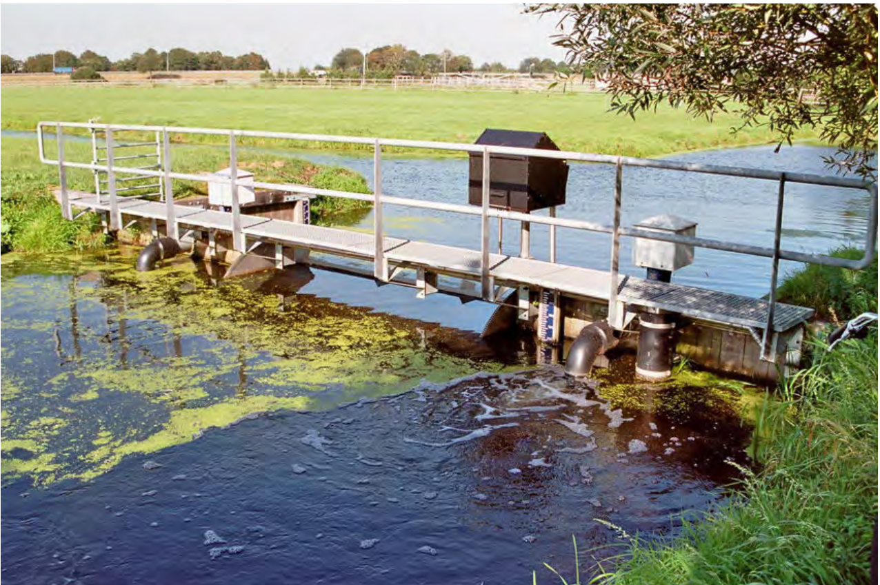
Figuur 58: Ontwatering langs het Oosteinde
